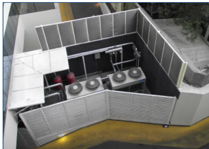
ARCADIS Ingeniería, Sala de Enfriamiento
